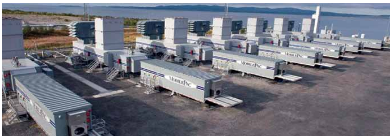
Фото 1, 2. Мобільні ГТЕС Gas Turbine MOBILEPAC Package, виробництва американської PW Power Systems LLC.
